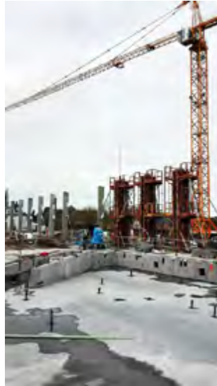
La dalle du bassin ludique est achevée (au premier plan). Les élévations se poursuivent au rez-de-chaussée.
